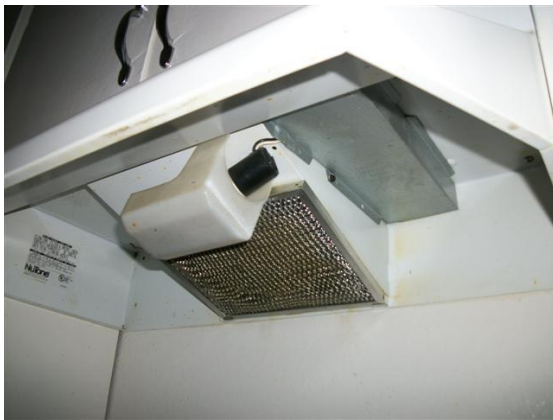
Inoperable exhaust fan
