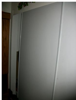
Inoperable closer door
